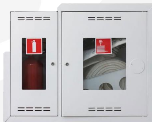
Nichos de incendios
